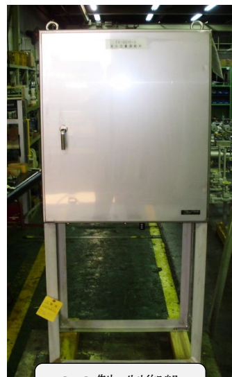
SUS 製 制御盤
